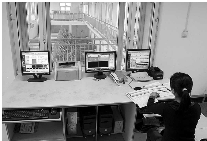
城市供水自动化
